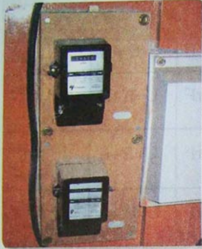
خزانة عدادات كهربائية من النوع الكهرومغناطيسي
