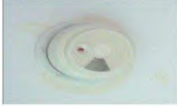
الشكل V-2: يمثل صورة جهاز إنذار الحريق
